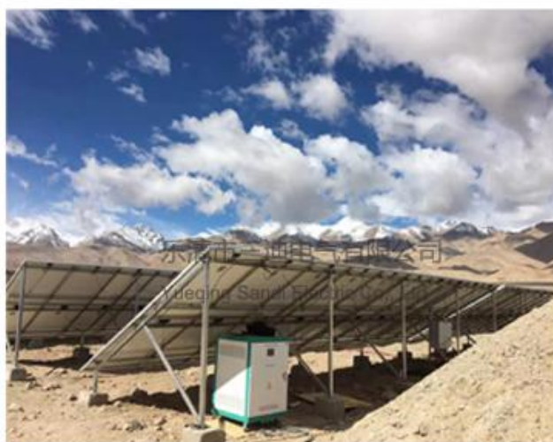
哈萨克斯坦45KW戈壁滩灌溉系统
