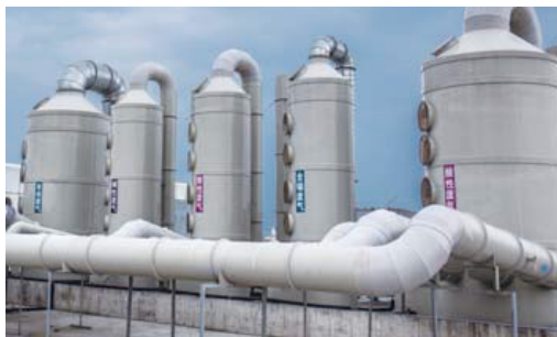
废气处理系统
